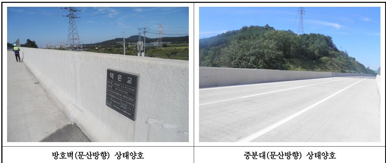
【사진 38.3.43】 방호벽 및 중앙분리대(문산방향) 손상현황
