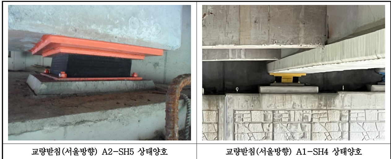
【사진 38.3.11】 교량받침(서울방향) 손상현황
